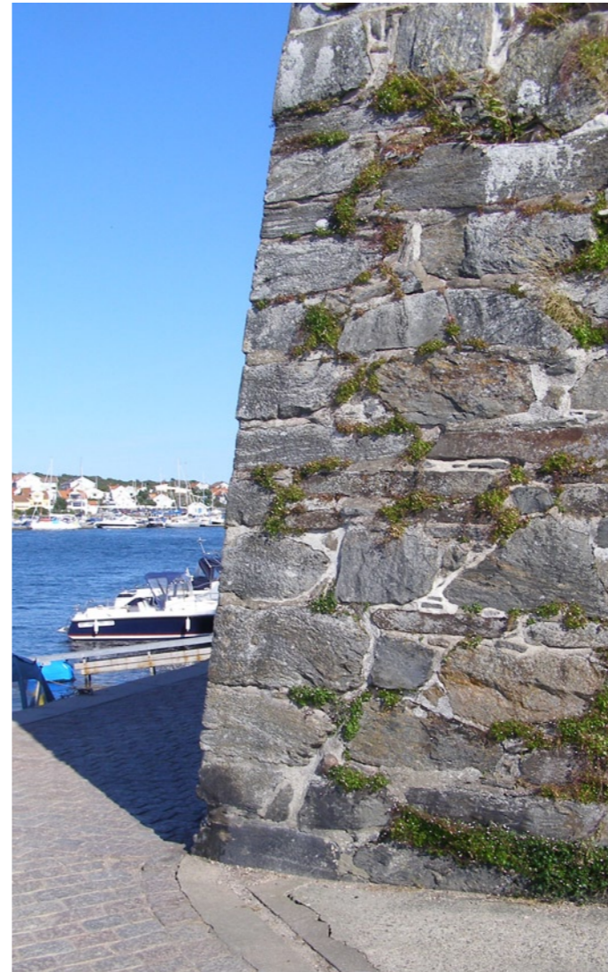
Bilden visar en naturstensmur i granit med oregelbundna fogar, Marsstrand, Sverige. Genom att stödmuren utformas med en viss lutning mildras det stela intrycket. Istället får muren ett mer dynamiskt och livfullt uttryck.
