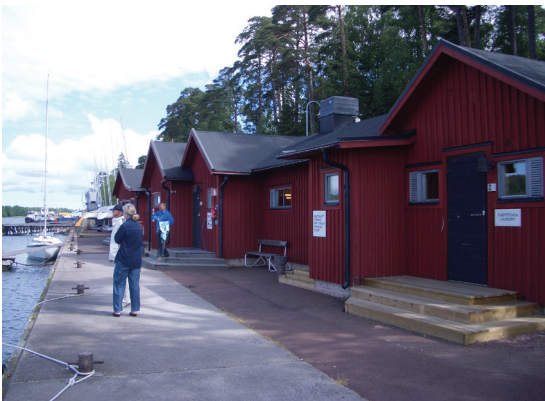
Dagens kaj med betongyta och en hålig asfaltsyta. Hålen i asfalten utgör en säkerhetsrisk då det är lätt att snubbla.
