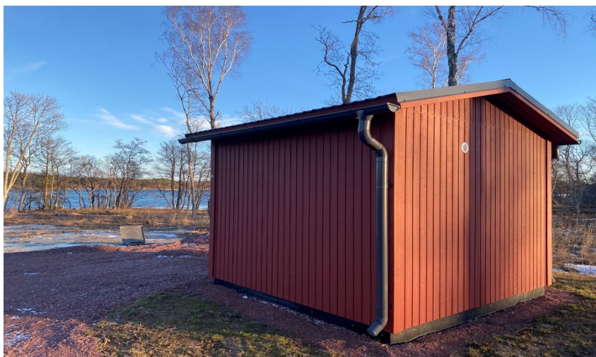
Bild 11. Avloppspumpstationen vid Södra Lillängen har en bräddningsbassäng för att eliminera bräddningar ut till havsviken Slemmern.
