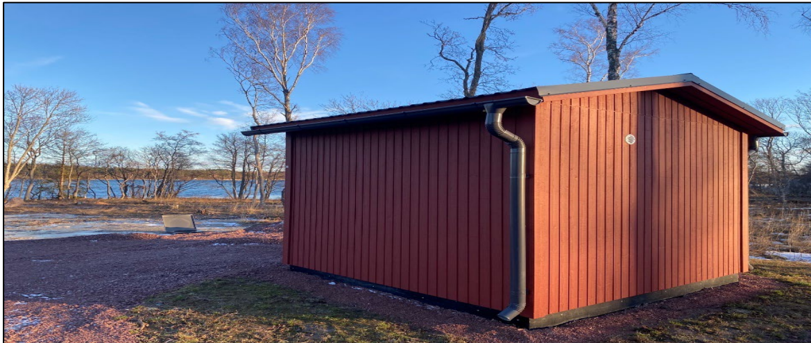
Bild 10. Vid nya bostadsområden där det krävs avloppspumpstationer installeras bräddningstankar om så är möjligt. Pumpstationen vid Södra Lillängen har en bräddningsbassäng motsvarande en dygnsvolym.
