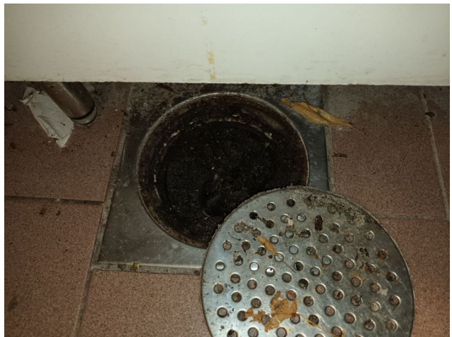
Golvbrunn smutsig och i behov av att rengöras.
