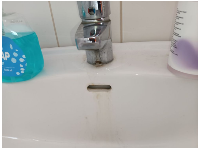
Vatten observerades läcka kontinuerligt från blandaren även när den är avstängd.
