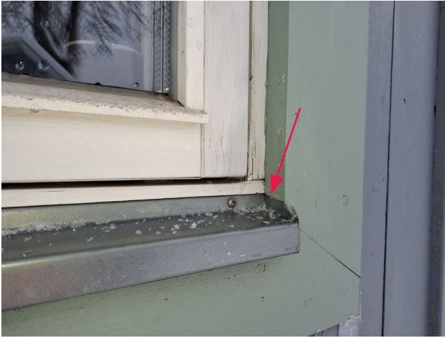
Fönsterplåtarnas kortsidor otätt monterade.
