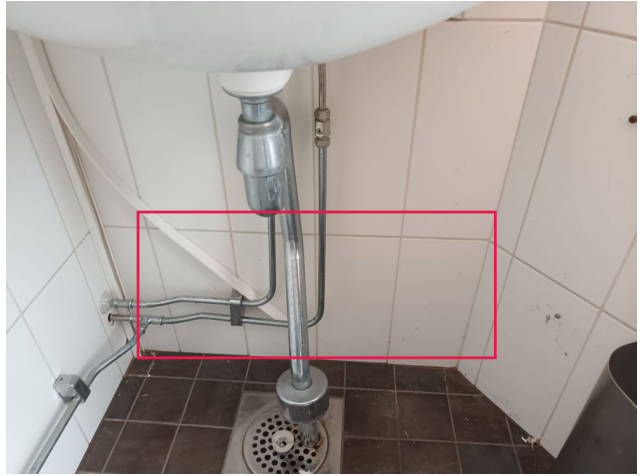
Område med avvikande ytfuktsvärden som uppmättes.
