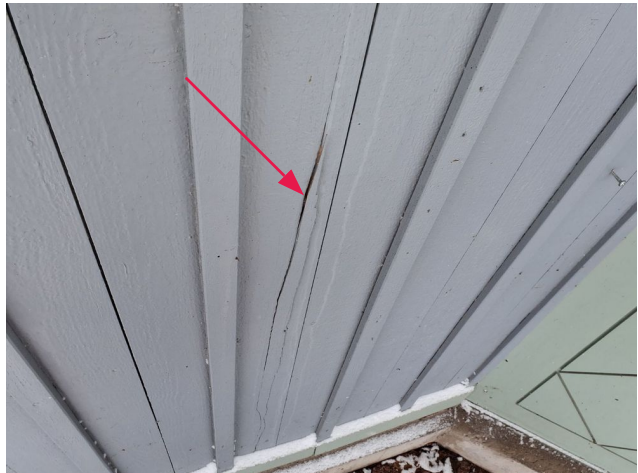
Träpanelen har ställvis spruckit upp på baksidan.
