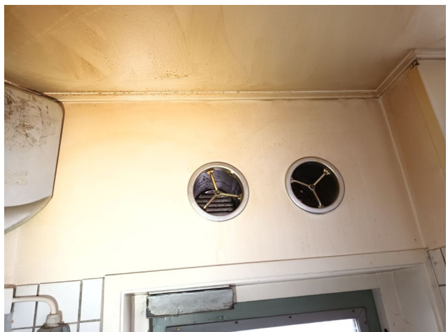
Ventilationsdonen saknas även på friskluftsventilerna.
