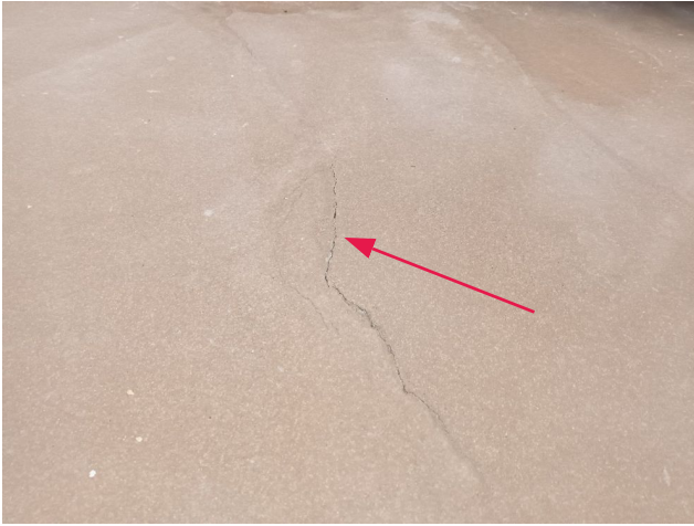
Spricka i golvbeläggningen var vatten kan tränga in till underliggande konstruktion.
