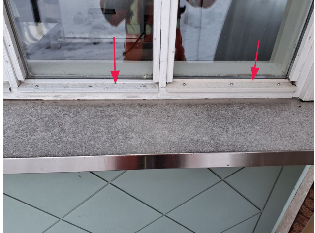
Plåtdetaljer vid köksdelens fönster observerades ha bytts ut ställvis.
