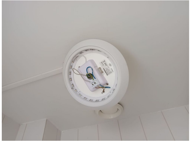
Takarmaturen har rivits ner i wc:n.
