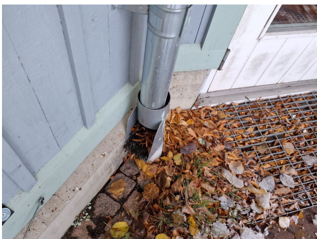
Lövgallren i behov av att rensas.
