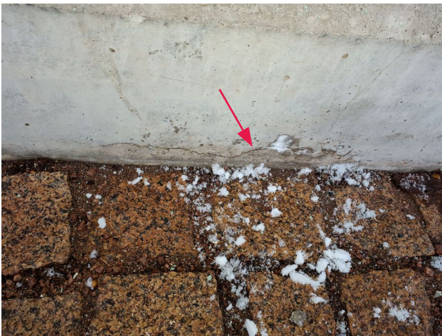
Sprickor observerades ställvis i sockeln.
