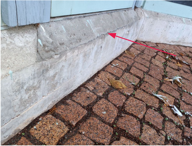
Spricka i sockel.
