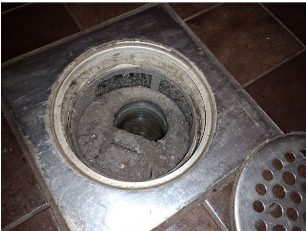
Golvbrunn smutsig och i beov av att förnyas. Vattenisolering observerades vara anslutet till golvbrunnen.
