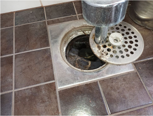
Golvbrunn av plast. Vattenisoelring anslutet med klämring som sig bör.
