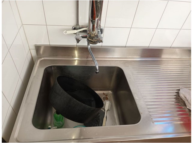
Vatten rinner långsamt bort från diskho vilket kan tyda på stock i avloppsröret.
