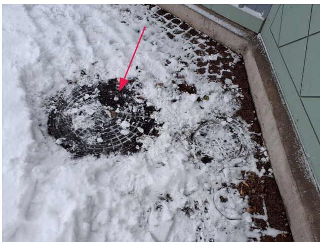
Ett större brunnslock observerades även på västra sidan man fick dock ej upp det vid granskningstillfället.
