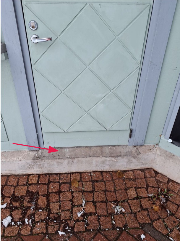
Tröskelplåtar saknas vid ytterdörrarna.
