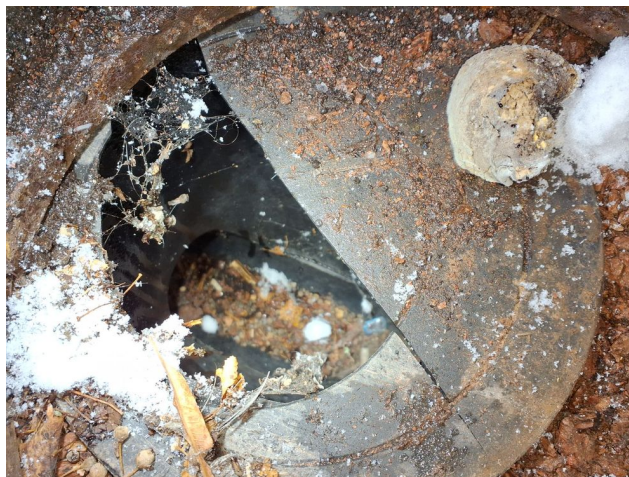
Man kan konstatera att rörsystemet under mark är i behov att rengöras då botten av röret är fylld med skräp vid båda kontrollbrunnarna.
