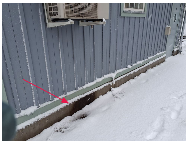
Kondensvattnet från luftvärmepumpen droppar ner på mark intill sockel vilket ökar på fuktbelastningen av sockeln.
