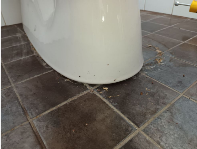
Silikonfogen saknas vid wc-stolens anslutning mot golvet.
