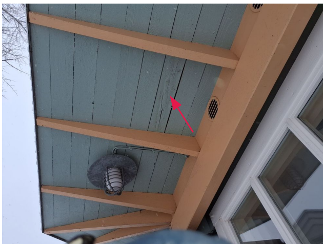
Skadad råspont observerades underifrån vilket kan indikera på att det finns otätheter i vattentaket.
