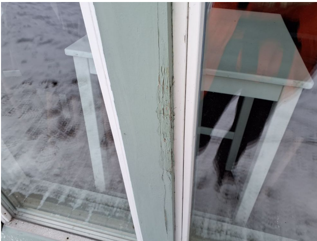
Färgen flagnar ställvis vid fönstren.
