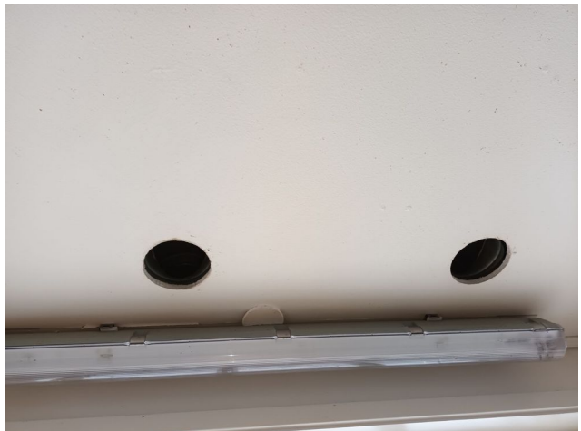
I köket saknas ventilationsdonen på rören.
