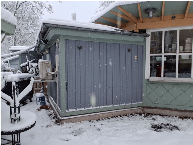
Överblicksbild fasaden på baksidan. Luftvärmepumpen fäst i väggen vilket kan orsaka buller i byggnaden då den går.
