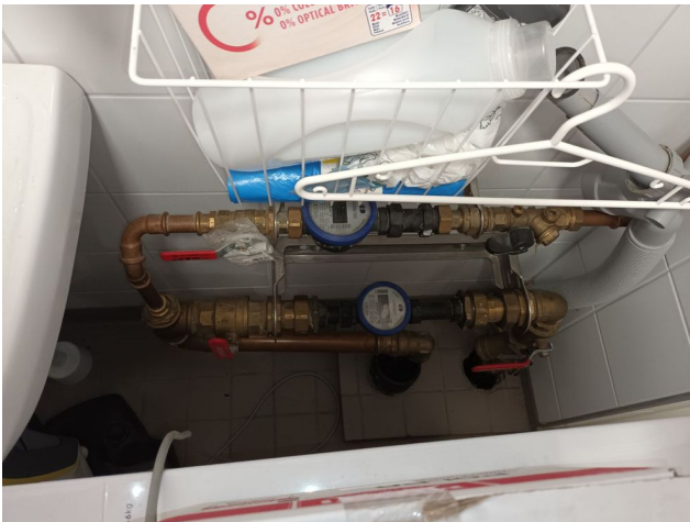
Inkommande vattenledningar av plast med två vattenmätare.
