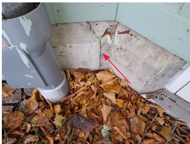
Spricka i sockel intill entrén.
