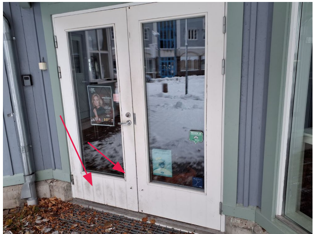
Ytterdörren vid huvud entrén. Färgen flagnar ställvis och smuts/algpåväxt på nedre delar av dörren. Underhållsmålning är att rekommendera för att förlänga livslängden på dörren.
