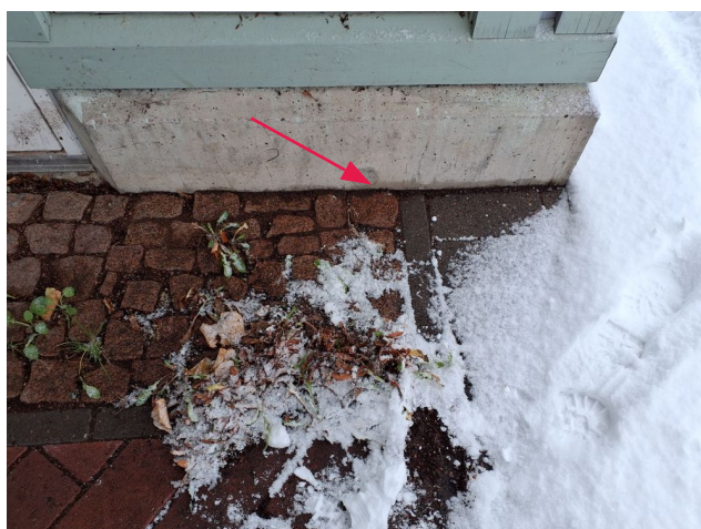
Fläckar i nedre kant av sockel indikerar på att sockeln belastas av markfukt.
