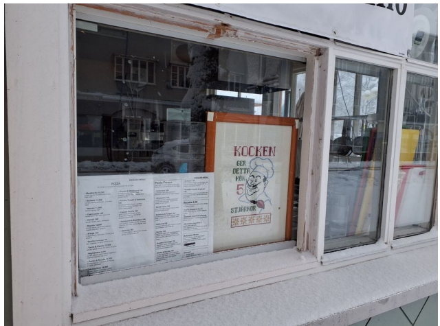
Yttre fönsterbågen är bortplockad vid kioskfönsterluckan. Risk för fuktinträngning och fuktskador på fönsterkarm finns.
