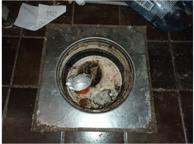
Golvbrunnen fylld av skräp.
