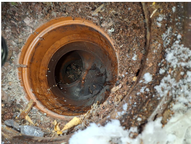
Kontrollbrunn tillhörande dränering eller regnvattensystem. Jord i botten vilket sannolikt hindrar vatten från att rinna längs med röret
