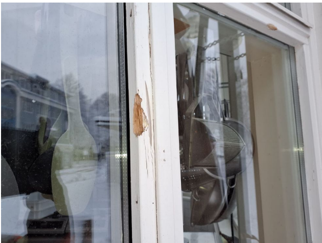
Skador finns även ställvis vid dessa fönster vid köksdelen.
