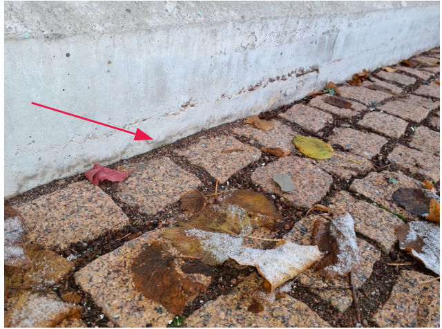
Fläckar som tyder att sockeln belastas av markfukt.
