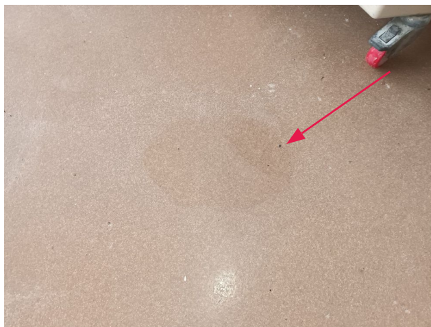
Ojämnheter förekommer ställvis i golvet i köket där vatten samlas.
